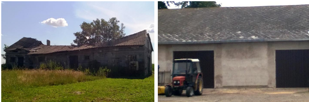
Rys. 1. Wyroby azbestowo – cementowe: po lewej płyty faliste, po prawej płyty płaskie, typ „Karo” (źródło: materiały własne)
